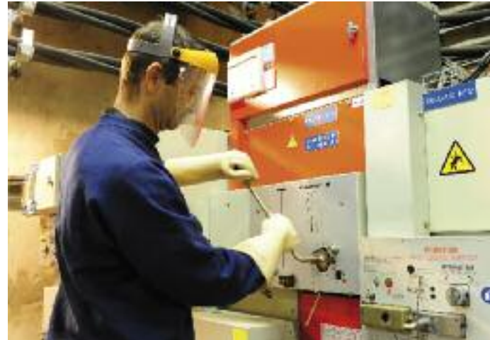
Équipement obligatoire pour assurer la maintenance électrique.
